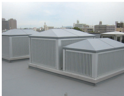
屋上空調換気ガラリ(熊本県)
