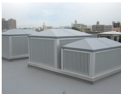
屋上空調換気ガラリ(熊本県)
